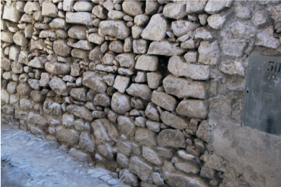
Figura 4.2.5. Taggia: paramento murario di scarsa qualità presso P.ta Barbarasa.
