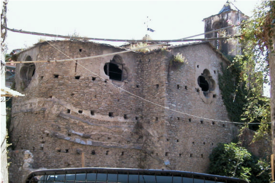
Figura 4.2.8. Taggia: muratura dell'abside di S. Teresa.
