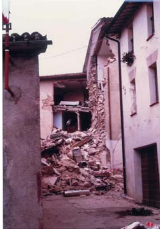
Figura 2. Strada ostruita da macerie di edificio (Umbria-Marche 1997)
