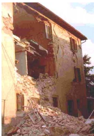
Figura 5. Ribaltamento di facciata in edificio in muratura (Umbria-Marche 1997)
