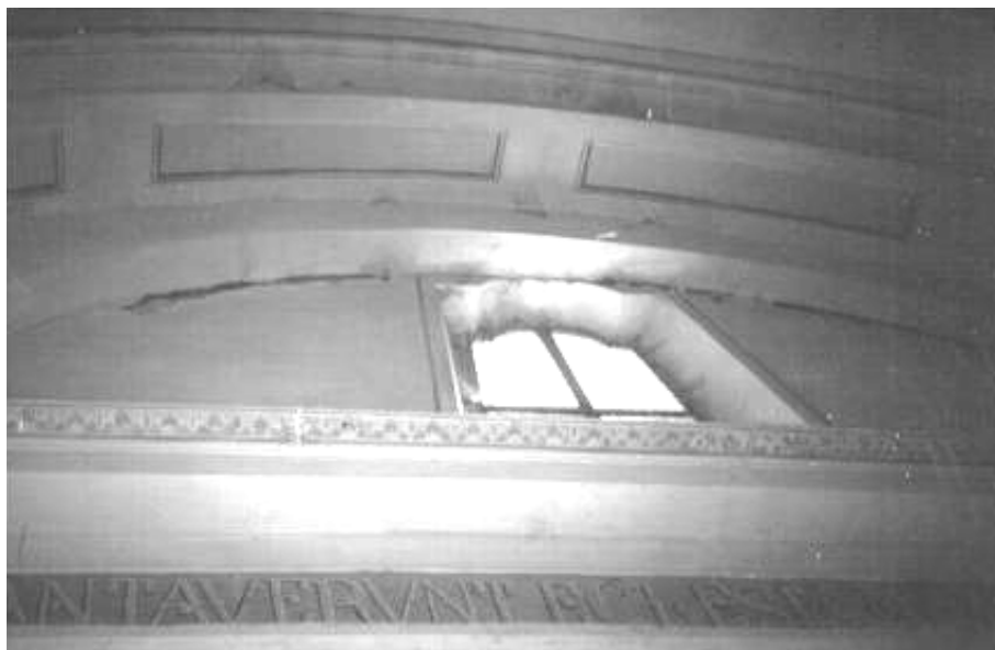
Figura 2 - Lesione tra la sommità della facciata e la volta a botte dell'aula
