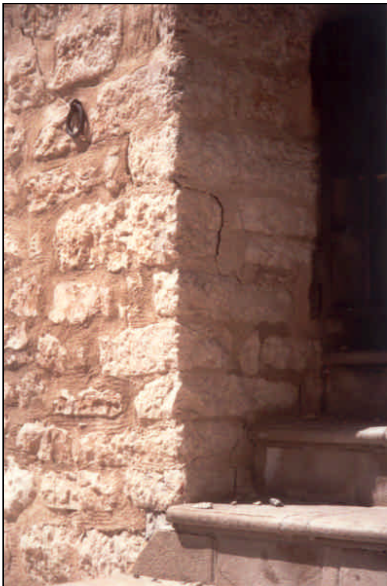
Facciata Nord-Est: prosecuzione della lesione che ha interessato le facciate Nord-Ovest ed imputabili al meccanismo di rotazione che ha interessato la parte superiore dell'edificio.
