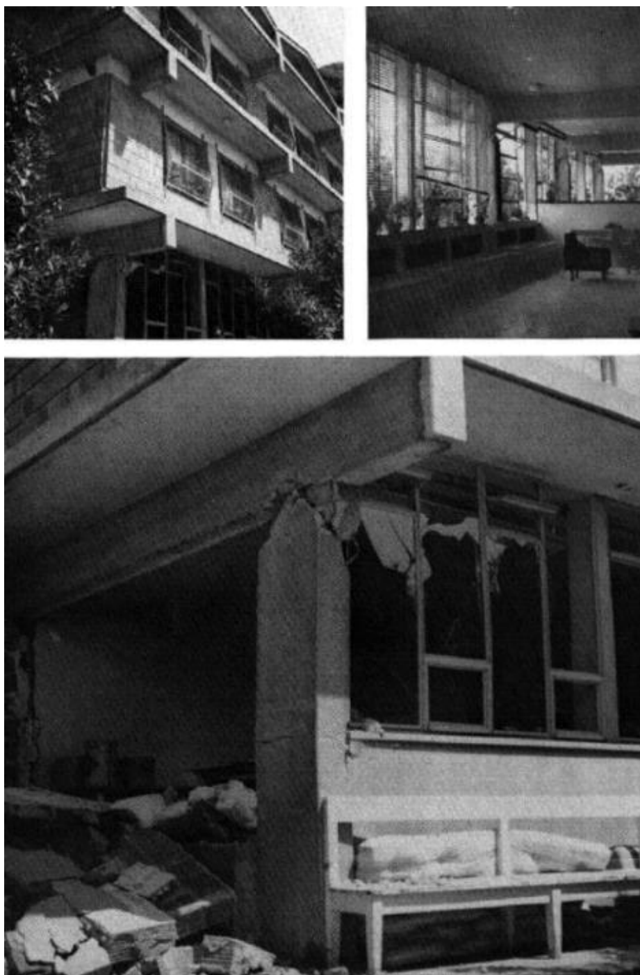
Fig. 1.3: Rottura a flessione e taglio dei pilastri per le tamponature parziali in altezza (da [5]).
