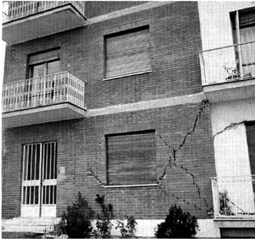
Fig. 1.5: Danneggiamento delle tamponature con la struttura integra (da [41]).
