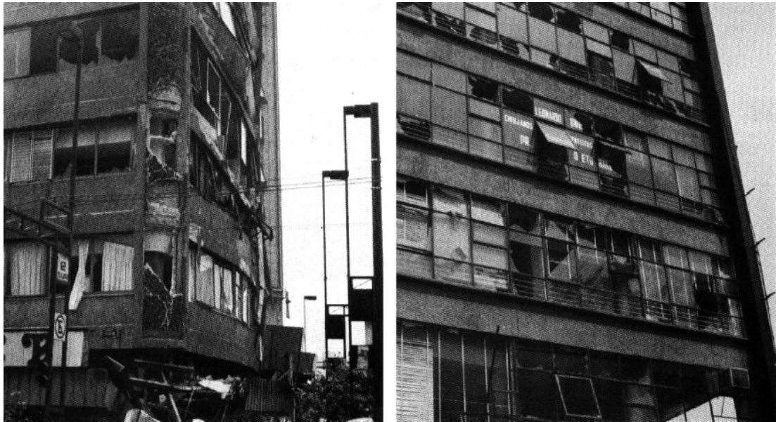
Fig. 1.7: Danneggiamento per le tamponature parziali in altezza: con parapetto, a sinistra, e con veletta, a destra (da [95]).
