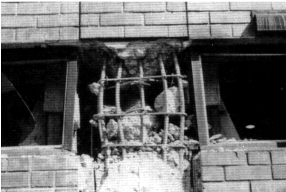
Fig. 1.8: Rottura a taglio del pilastro per le tamponature parziali in altezza (da [83]).
