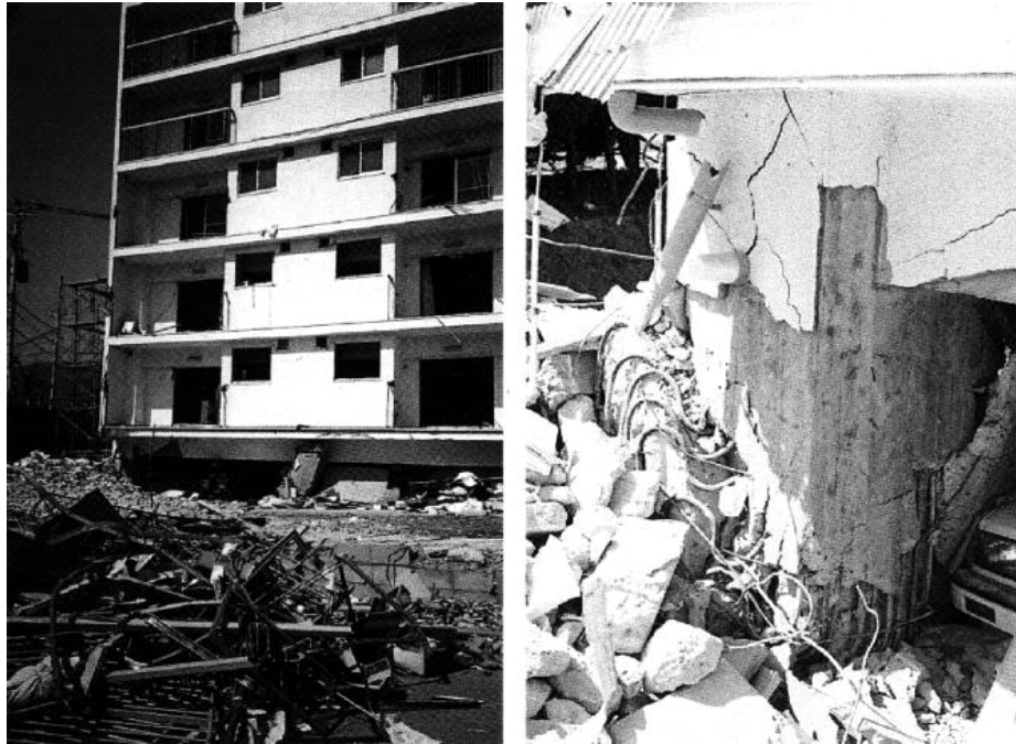
Fig. 1.9: Crollo completo del piano terra a pilotis (da [65]).
